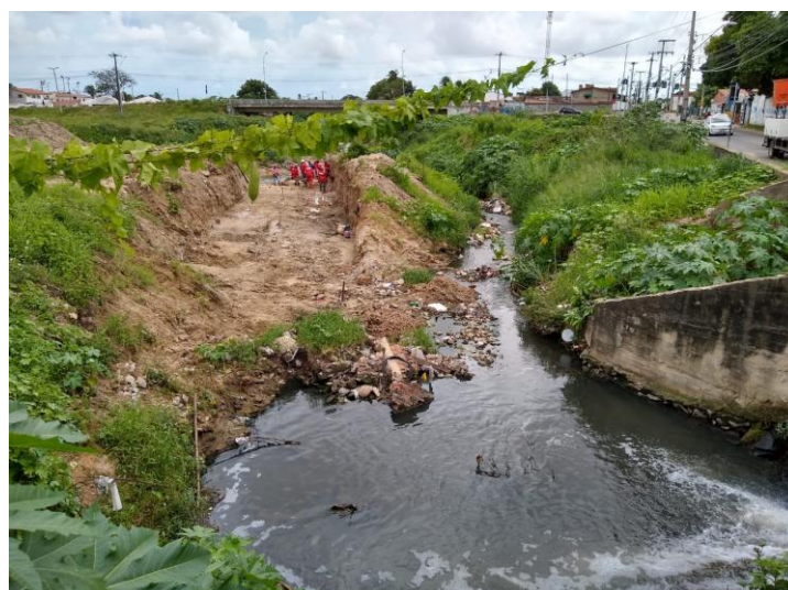
Figura 3 - Drenagem de águas pluviais existente na região.
